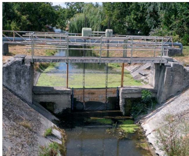
Stavidlo – základný prvok regulácie vody v hydromelioračných kanáloch.
